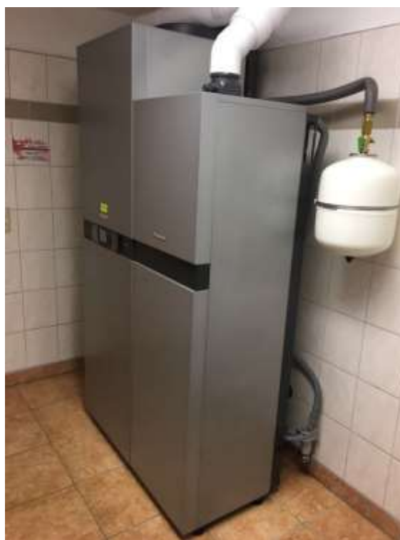
Brennstoffzellenheizung - Inbetriebnahme 2015 © Faber Wartung & Service GmbH
